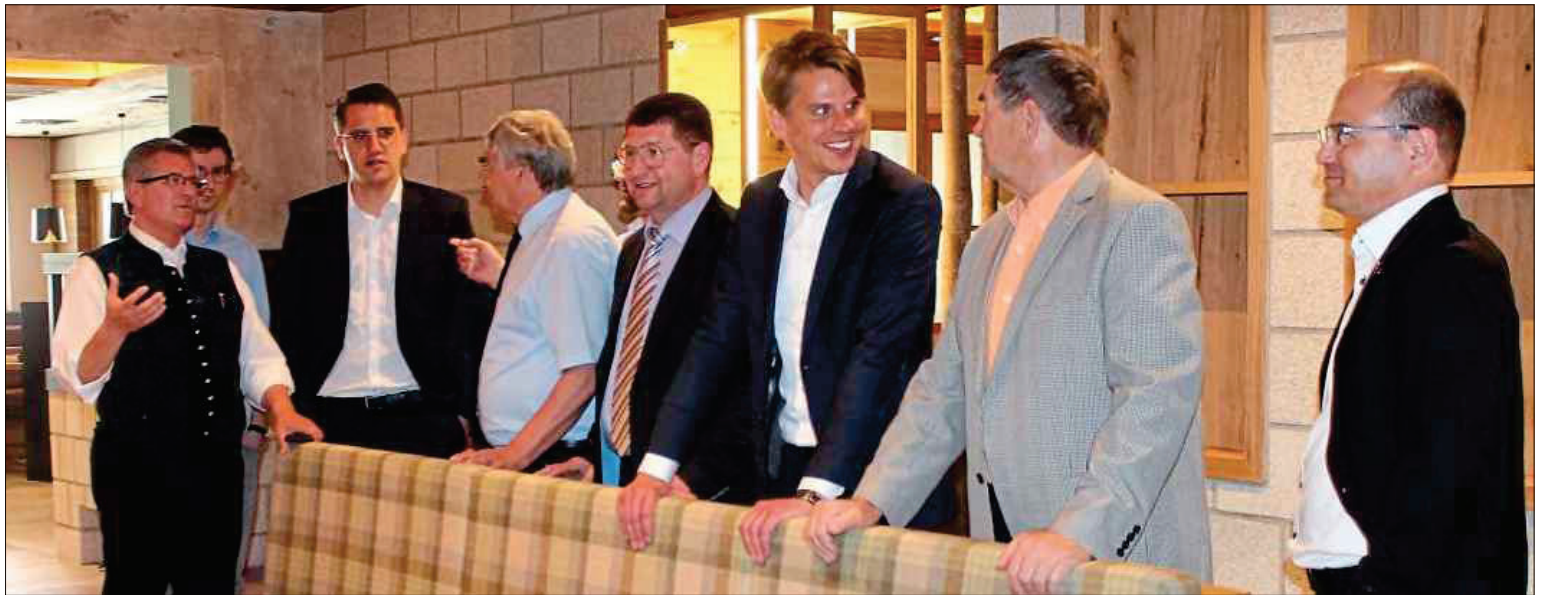
Andreas Brunner (links) zeigt Christian Doleschal (Zweiter von links) die Umbauarbeiten im Hotel.
